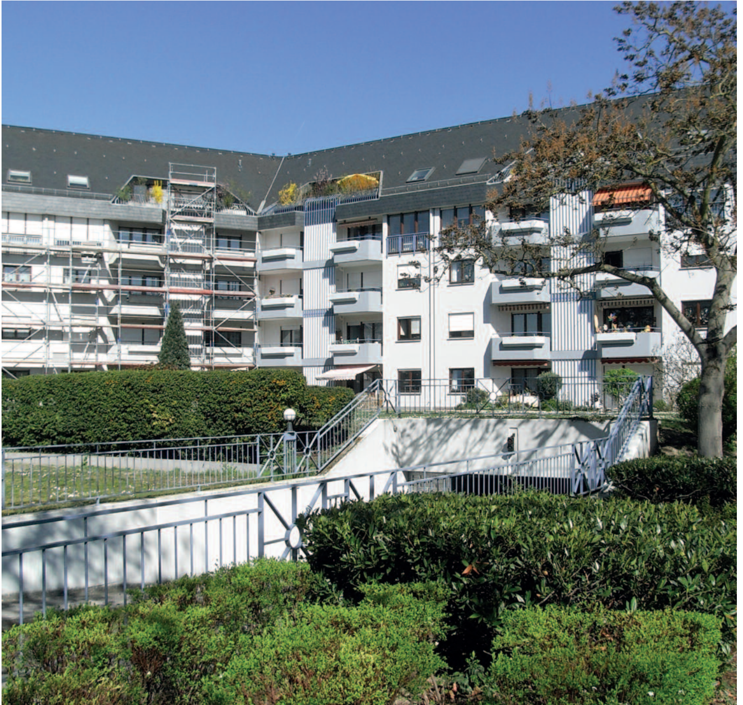
Wolframstraße 27 - 29 nach Fassadenrenovierung im Jahr 2013 und Wolframstraße 31 - 33 eingerüstet für die Renovierung in 2014
