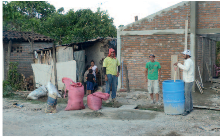
Für den Neubau müssen oft die alten Hütten (wie hier) abgerissen werden.
